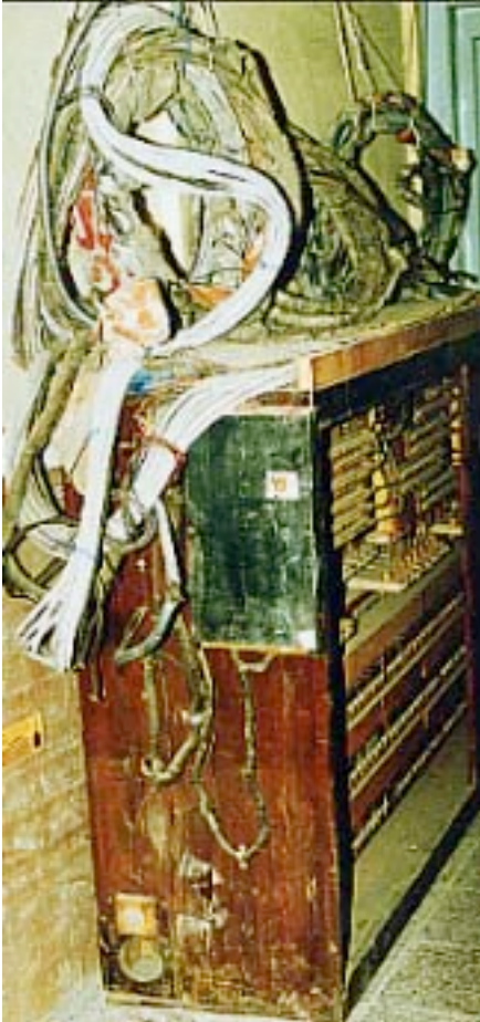
Schaltschrank der Orgel vor der Restaurierung
